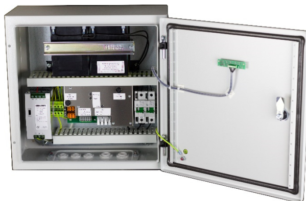
All-In-One USV im Schaltschrank
